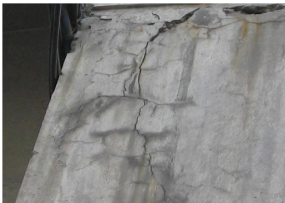
圖 4. 水泥建築所產生的龜裂 ↑
